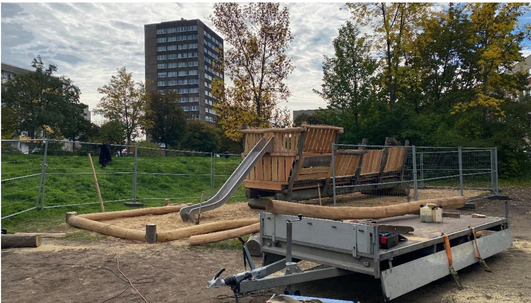
Foto: Um- und Instandsetzung Spielschiff „WIKI“ auf der Freifläche Prager Straße, Copyrights Wohnungswirtschaft Frankfurt Oder (GmbH)
